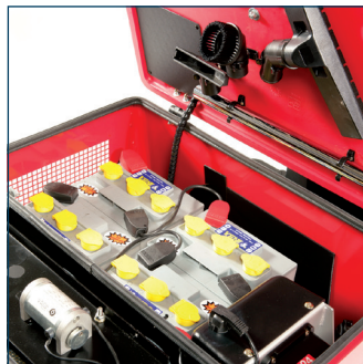
4 - 240 Ah (20h) batterijen 4 batteries 240 Ah (20h)
